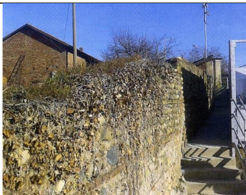
Centrale Rocca: muro prima del ripristino
