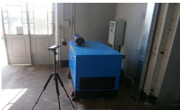
Misura del rumore presso la Centrale Petiva
