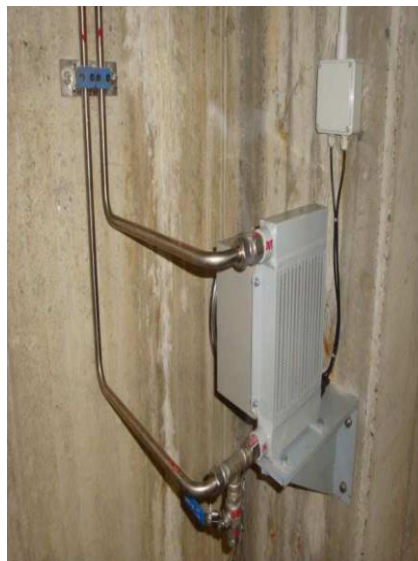
Scambiatore al piano interrato
