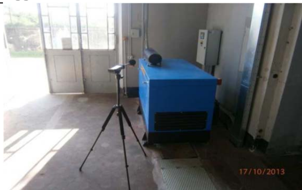
Misura del rumore presso la Centrale Petiva
