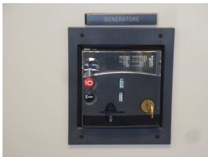
Nuovo interruttore di parallelo
