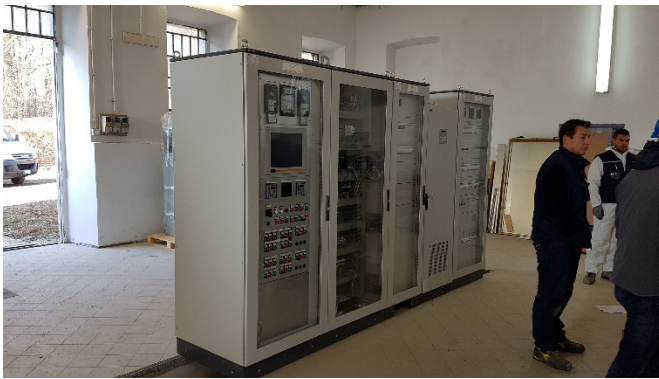
Quadri di comando e automazione
