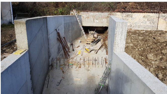
Edificio alloggiamento valvola by-pass e relativo canale
