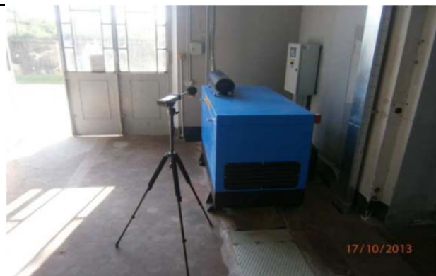
Misura del rumore presso la Centrale Petiva
